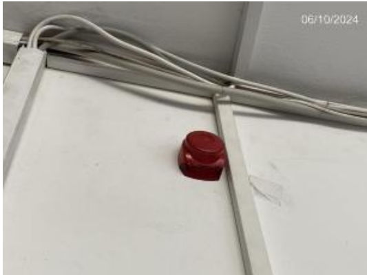
visible fire alarm .JPG
