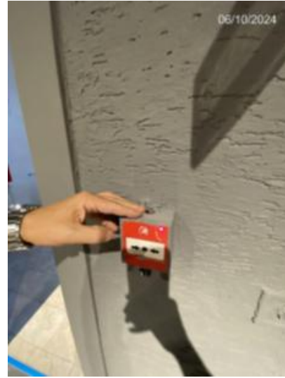
fire alarm testing.JPG
