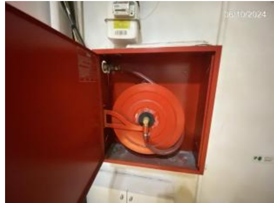
fire hose .JPG
